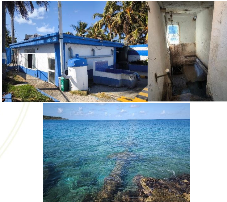
Gráfico 4.30 ESTACIÓN DE BOMBEO Y EMISARIO SUBMARINO, SAN ANDRÉS
