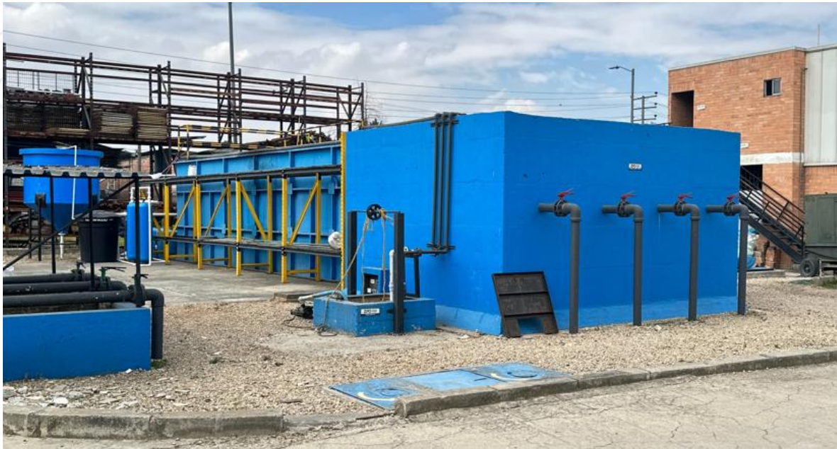
GRÁFICO 3.31 PLANTA DE TRATAMIENTO DE AGUAS RESIDUALES DOMÉSTICAS DE TIPO BIOLÓGICO – ZFO
