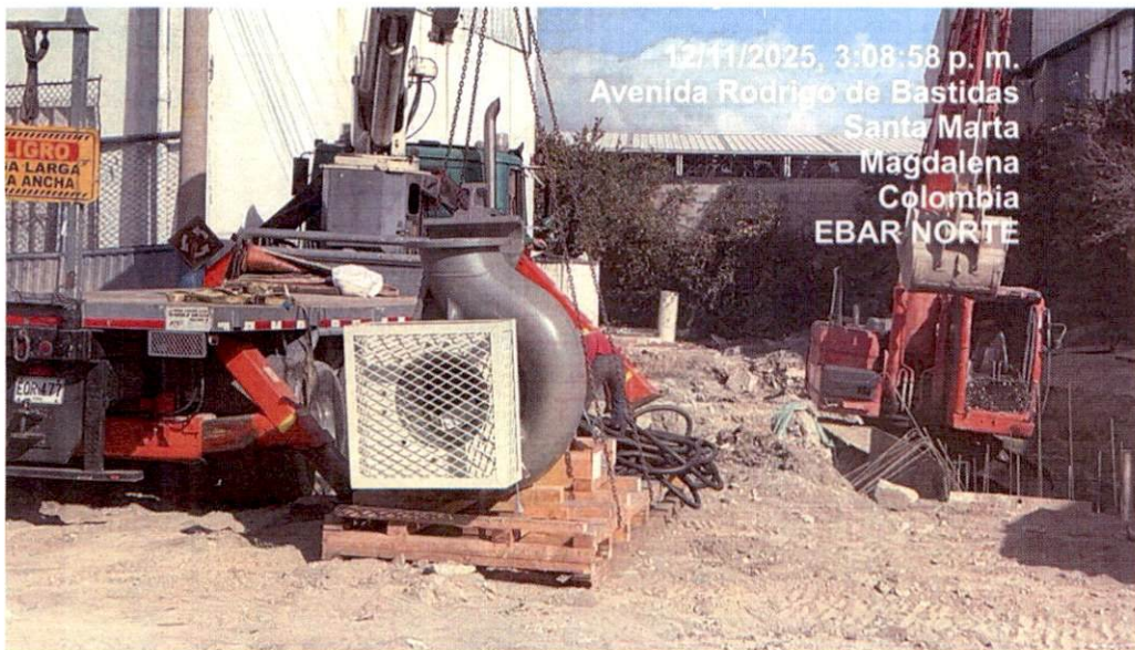
Figura 4. Ingreso bomba nueva EBAR NORTE.
