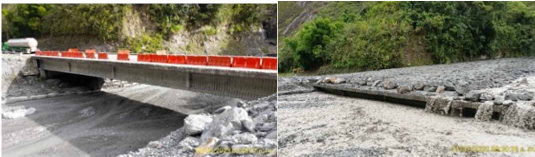
Ilustración 4. Antes y después del Puente Estaquecá – S1 (K46+149)
