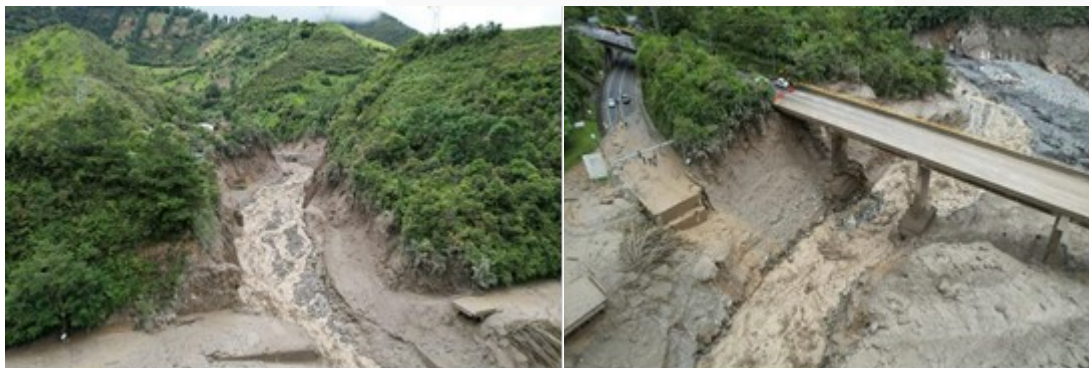
Ilustración 2. Panorámica de la zona de afectación en el Puente Naranjal S2 y de la calzada, debido a la creciente y desbordamiento de la Quebrada Puerto Grande.
