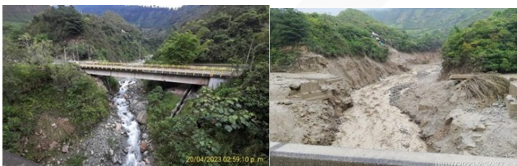
Ilustración 1. Antes y después del colapso del Puente Naranjal – S2 (K50+405)
