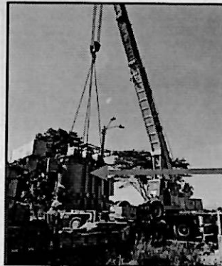
Descargue de transformador de 10 MVA Nº SERIE: 142859-1309 en la subestación Apiay
