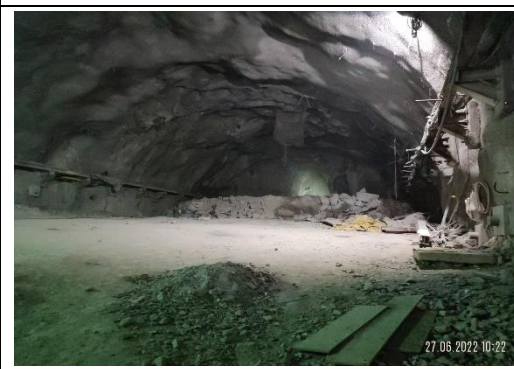
Fotografía 4 - Casas de Máquinas Sur – Material alojado sobre Unidades 7 y 8
