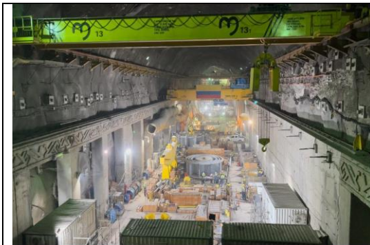
Fotografía 1 - Casa de Máquinas Sur – Sala de montajes - Vista general desde zona sur hacia unidades 6 y 5
