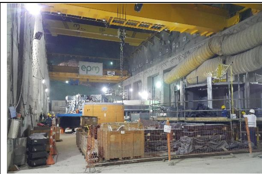
Fotografía 2 – Casa de Máquinas Sur – Sala de montajes sobre las Unidades 5 y 6
