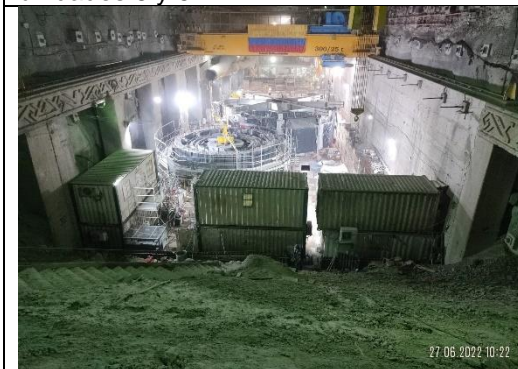
Fotografía 3 - Casas de Máquinas Sur – Material alojado sobre Unidades 7 y 8
